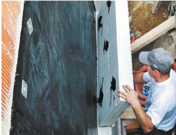
Collage des panneaux de Knauf Perimaxx Resist sur le support, de bas en haut
